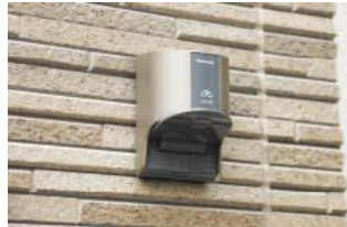
EVコンセント
