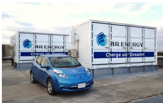
リユース蓄電池の活用
