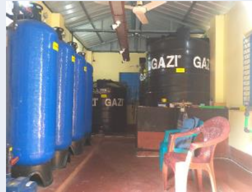
プラント内水処理設備
